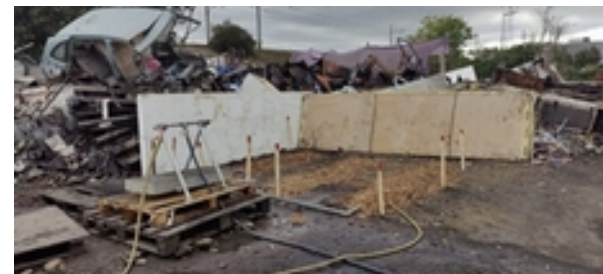
Accompagnement de l'ONG Solidarités International sur la précarité sanitaire, avec l'installation de filtres à broyat de bois pour le traitement des eaux ménagères issues des douches dans un bidonville à Toulouse
