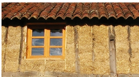
Mur terre paille allégé
