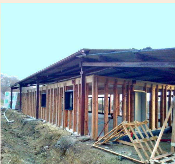
Pose de l'ossature bois sous le hangar après coulage de la dalle en autoconstruction
